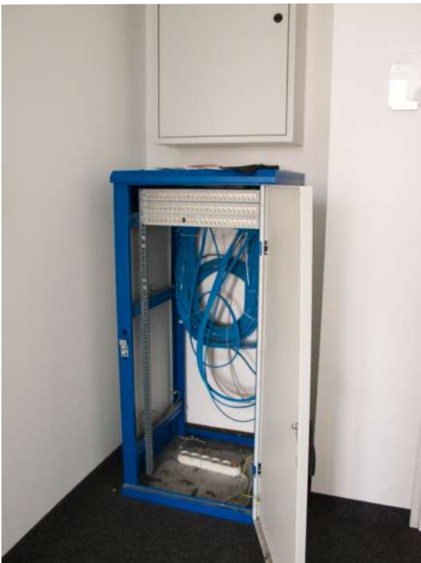
Serverschrank mit LAN-Anschlüsse
