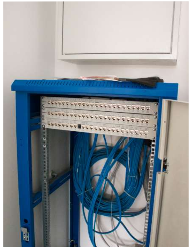
Serverschrank mit LAN-Anschlüsse
